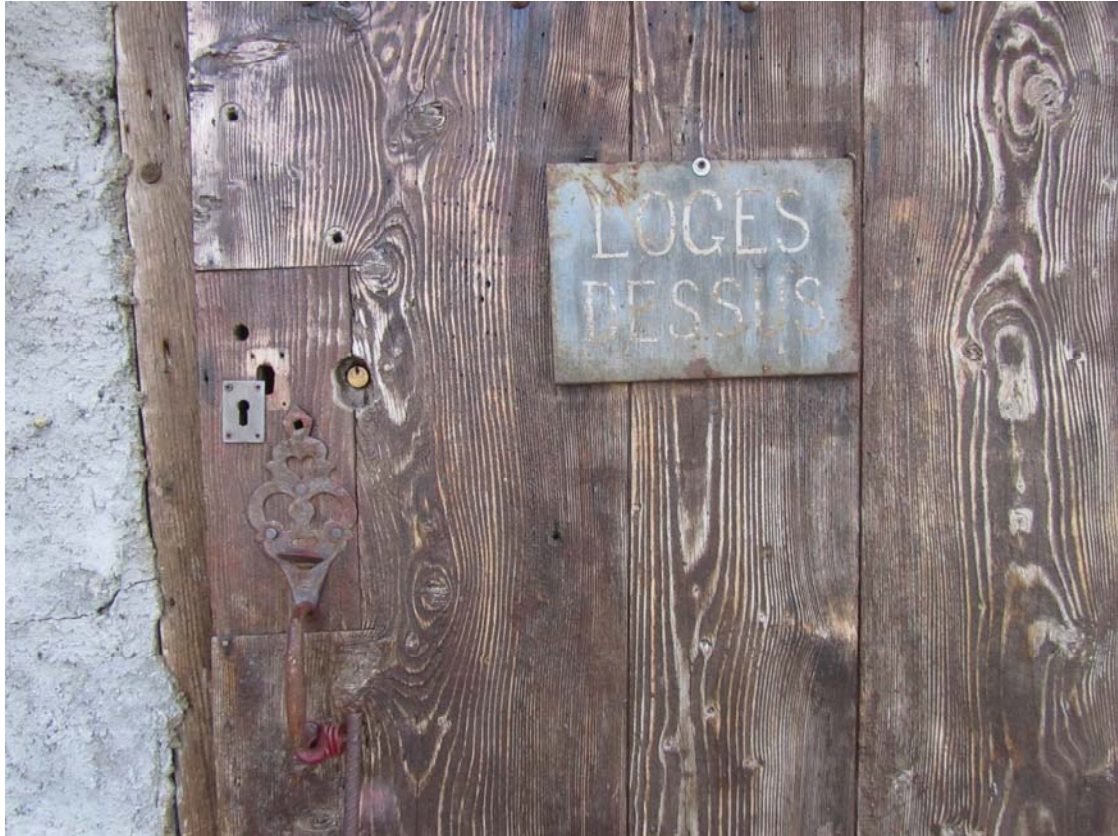
Un péclet de toute beauté pour une porte qui a vu l'usage de combien de serrures différentes ?
